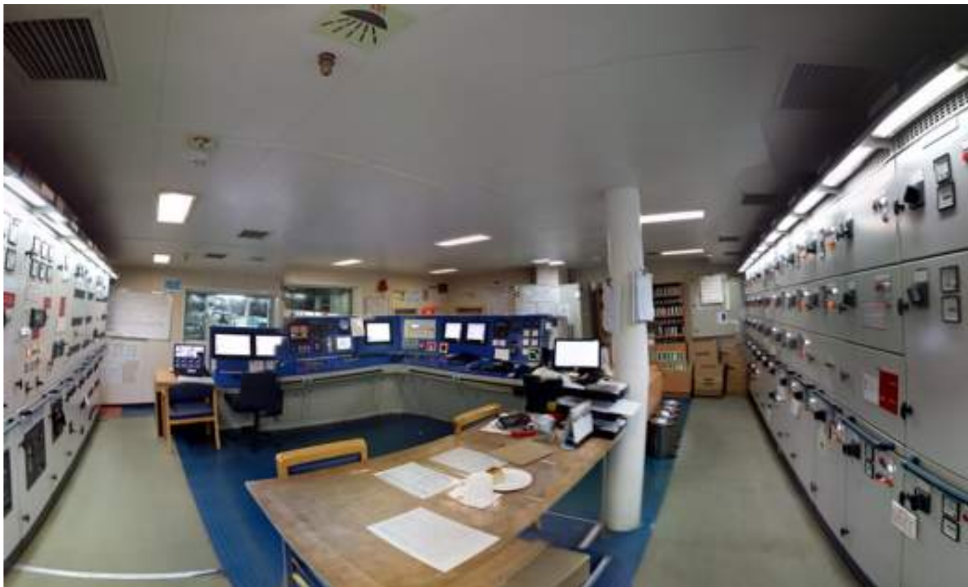
I pannelli di controllo della sala macchine: alle pareti i quadri elettrici, triplicati rispetto alle esigenze della nave
